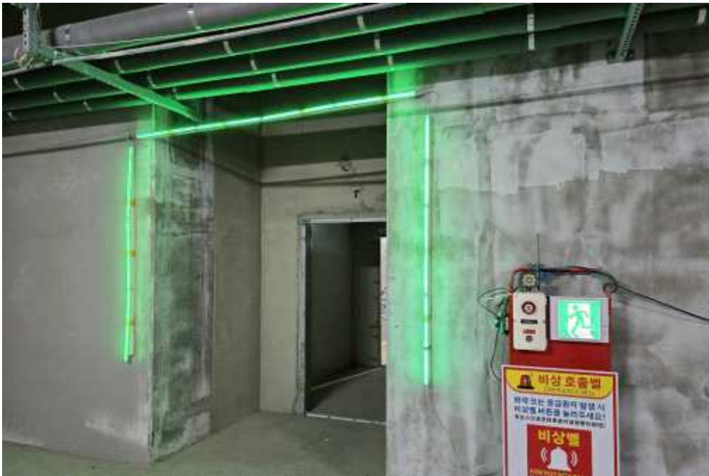
[그림 V-6] 비상조명등 설치 사진
