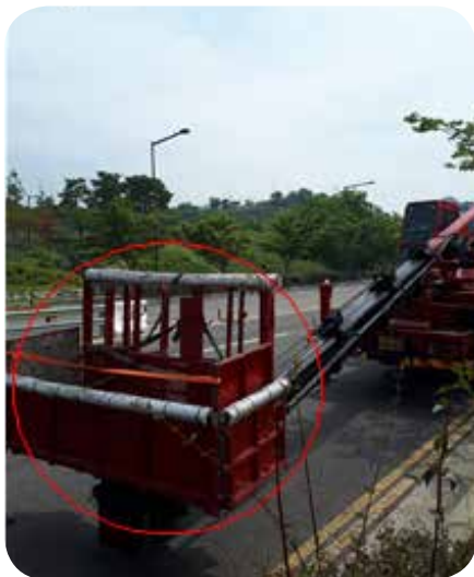
고소작업대 작업대 안전난간 미설치로 떨어짐 위험
