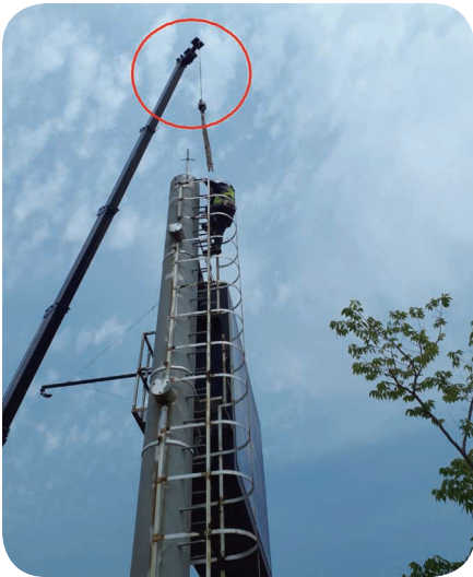
이동식크레인 권과방지장치 미설치
